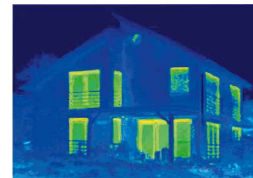
Après l'installation méticuleuse de nouvelles fenêtres du système Schüco LivIng, la thermographie montre les avantages énergétiques de l'investissement. La perte d'énergie initiale est quasiment inexistante.
